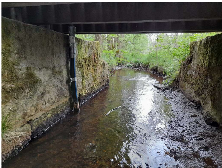
Obrázek 21. Vodoměrná stanice Újezdský potok
